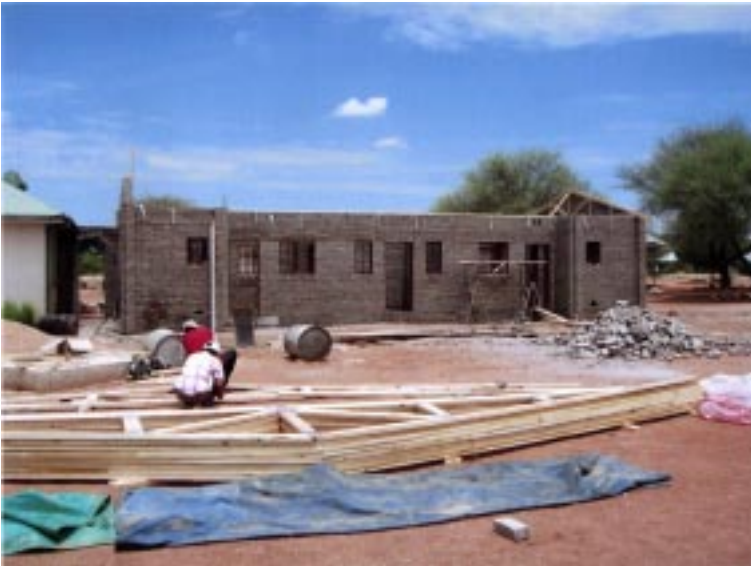
Rohbau der neuen Klinik in Otjikondo. Im Vordergrund die Holzkonstruktion für das Dach des Gebäudes.
